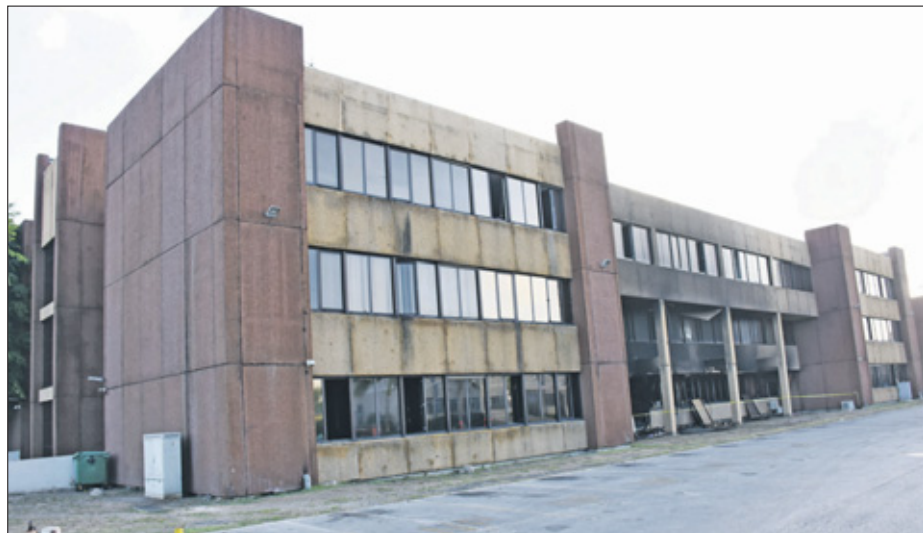
Door de brand die in augustus bij het belastingkantoor woedde, wordt een groot deel van het gebouw verwoest. Onder andere de inspectie moet op zoek naar een ander onderkomen. FOTO JEU OLIMPIO
